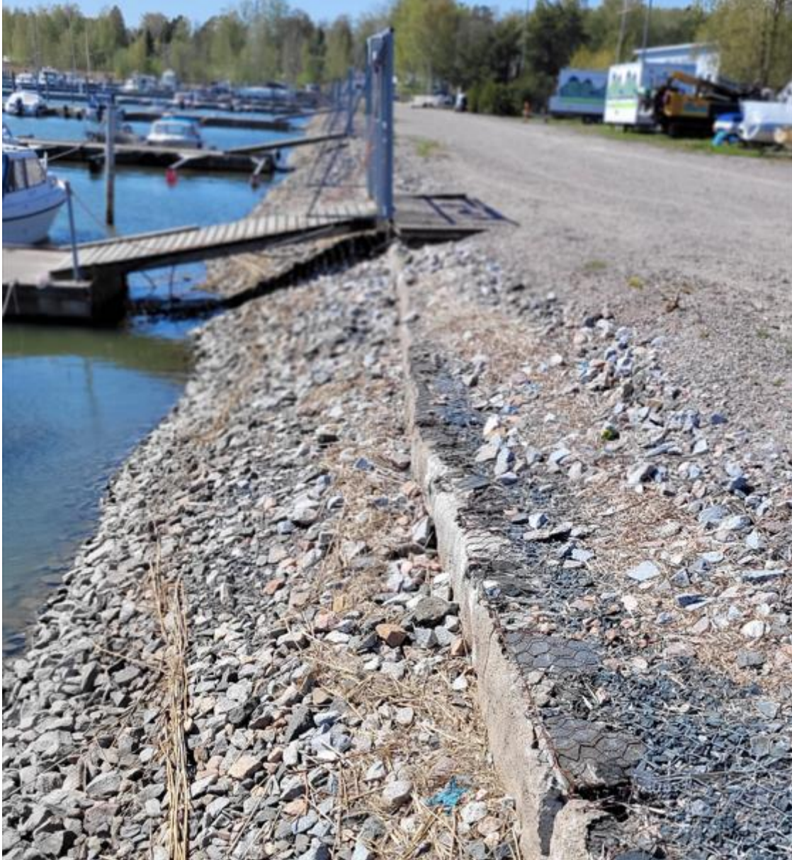
Kuva 5.4: Louhe/sepelitukitäytöllä korjattua kivikorirakennetta 13.5.2023. Kivikorin merenpuoleisessa pinnassa näkyy aikoinaan korjaustoimenpiteenä tehty ruiskubetonointi.
